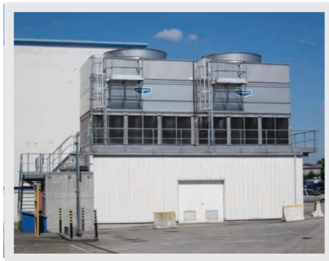
► Tour de refroidissement à haut rendement
